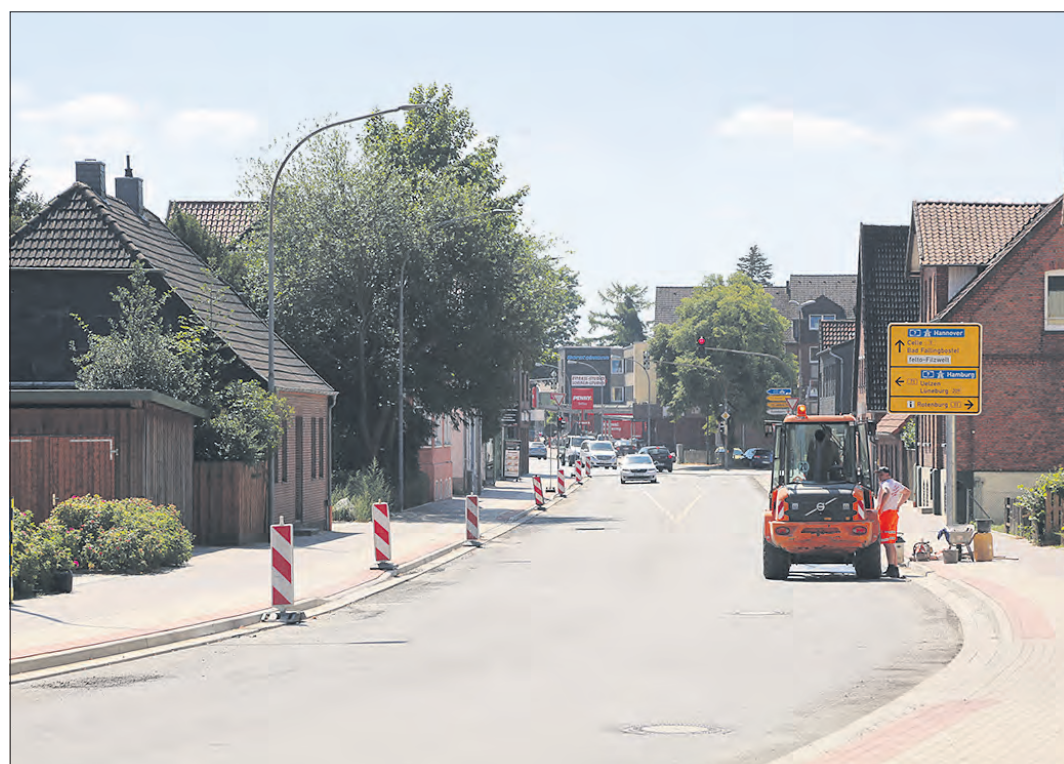
Ab Montag, den 30. Juli, wird die Winsener Straße in Soltau zunächst von der Lüneburger Straße bis zum neuen Kreisel gesperrt.
