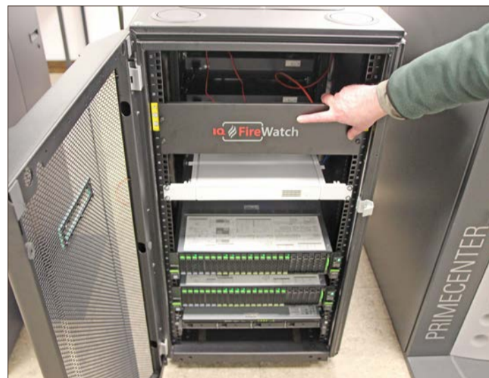
Ein neuer Server sorgt für die nötige Rechenleistung des Waldbrand-Überwachungssystems.
