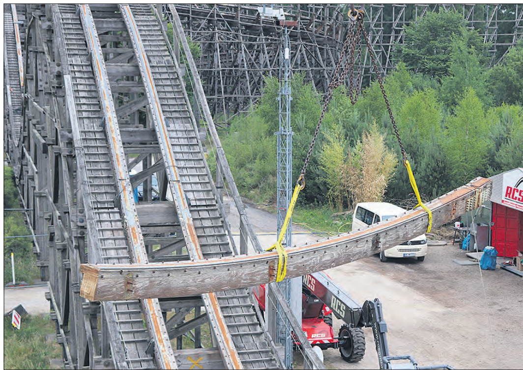
Stück für Stück werden die alten Schienen der gigantischen Holzachterbahn „Colossos“ entfernt.
