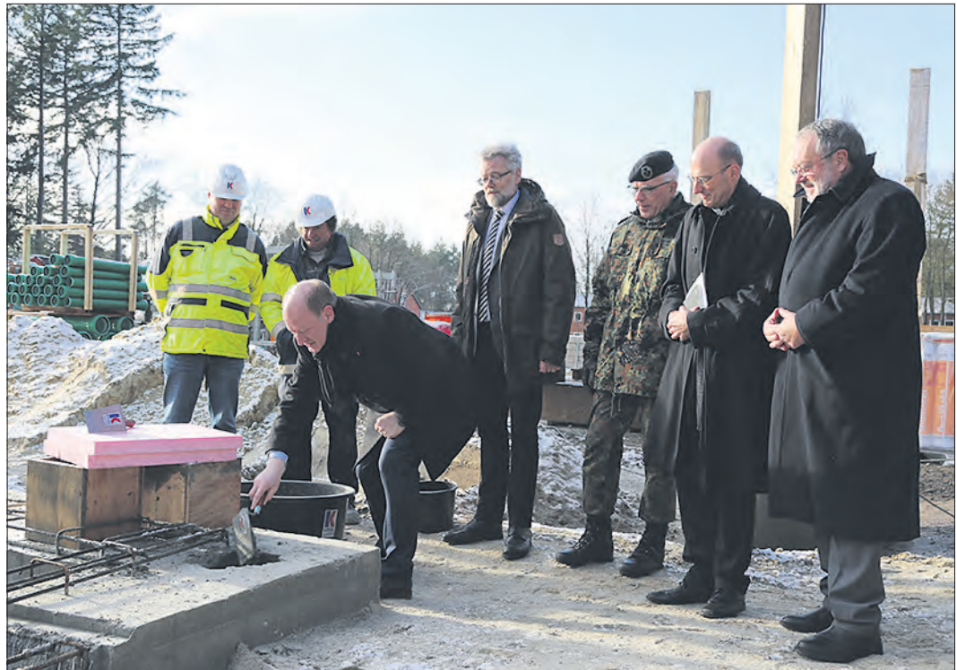
Niedersachsens Finanzminister Reinhold Hilbers griff vor den aufmerksamen Augen der Bauleute zur Maurerkelle, zementierte bei der feierlichen Grundsteinlegung die „Zeitkapsel“ ein. Rückendeckung beziehungsweise kirchlichen Beistand gab es dabei von (v.re.) stellvertretendem Bürgermeister Gerd Engel, Militärfarrer Yves Töllner, Brigadegeneral Olaf Rohde und Michael Brassel, Leitender Baudirektor und Amtsleiter des Staatlichen Baumanagements Lüneburger Heide.
