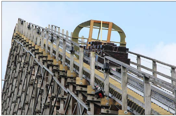
Beim sogenannten „Pullthrough-Test“ wird ein Wagen manuell über die Bahn gezogen, um eventuelle Unregelmäßigkeiten zu entdecken.
