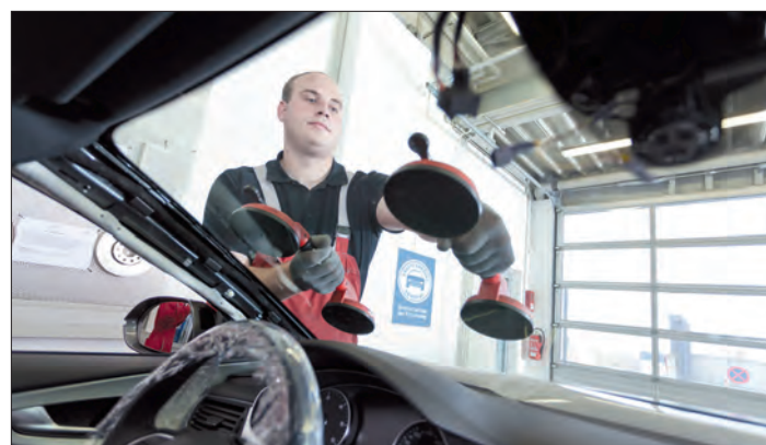
Es ist Pflicht, die Scheibe zu tauschen, wenn sich der Schaden im Sichtfeld des Fahrers befindet. Werkfoto: ProMotor/Volz
