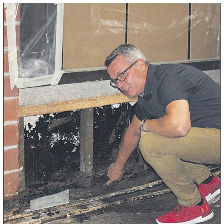
Ingo Zillmann weist auf die Wasserschäden hin.
