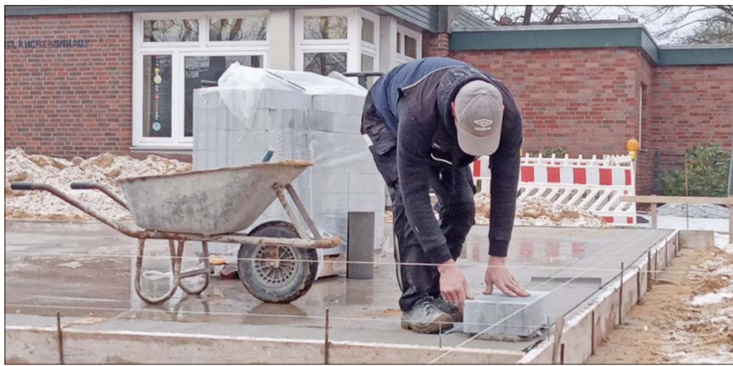
Großer Anlass, kleiner Kreis: Die Grundsteinlegung für den Erweiterungsbau der Tagespflege am Melanchthonhaus in Soltau verlief in aller Stille. Foto: Heiko Schütte, Superintendent des Kirchenkreises Soltau
