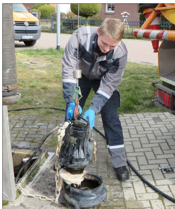
Lukas Maiwald, Mitarbeiter der Stadtwerke, reinigt eine verstopfte Abwasserpumpe.
