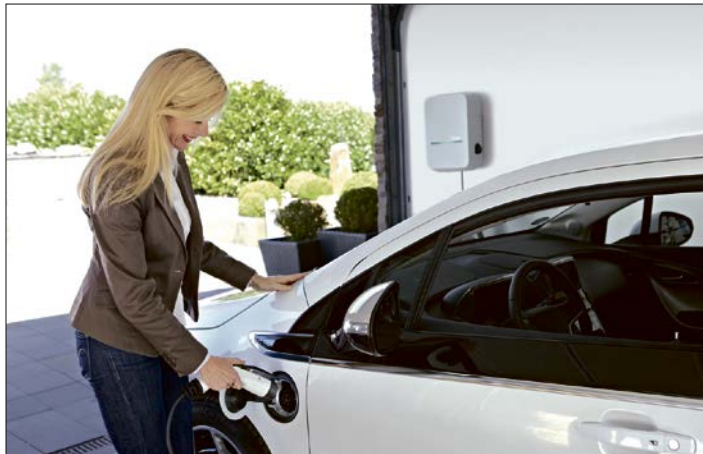
Die Installation der Wallbox oder einer frei stehenden Ladesäule sollten E-Auto-Fahrer unbedingt einem Fachmann überlassen.
