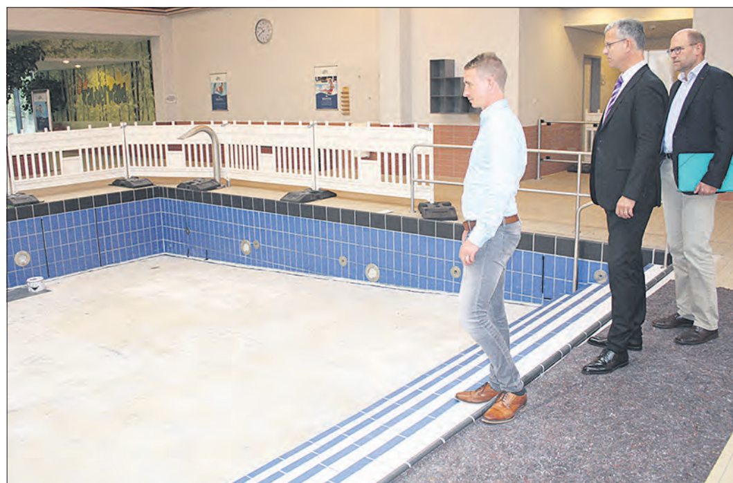
Die Bodenfliesen sind bereits aus dem Lehrschwimmbecken entfernt worden: (v.l.) Ronny Dechau, Dr. Claus-Jürgen Bruhn und Volker Stegen beim Gang durchs Hallenbad. Foto: mwi
