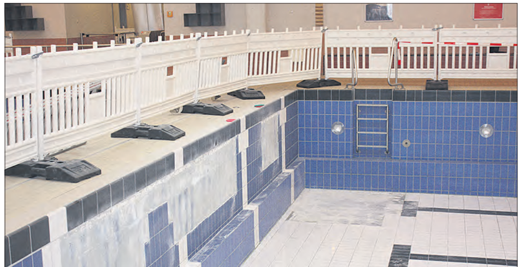
Schon seit Ende August 2018 herrscht Ebbe im Soltauer Hallenbad. Die Schäden können noch nicht behoben werden.
