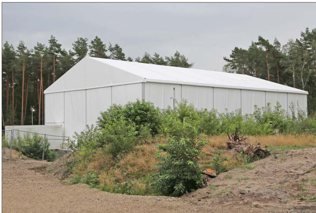
In diesem hallengroßen Zelt werden die Arbeiten zur Öffnung des Dethlinger Teiches laufen.
