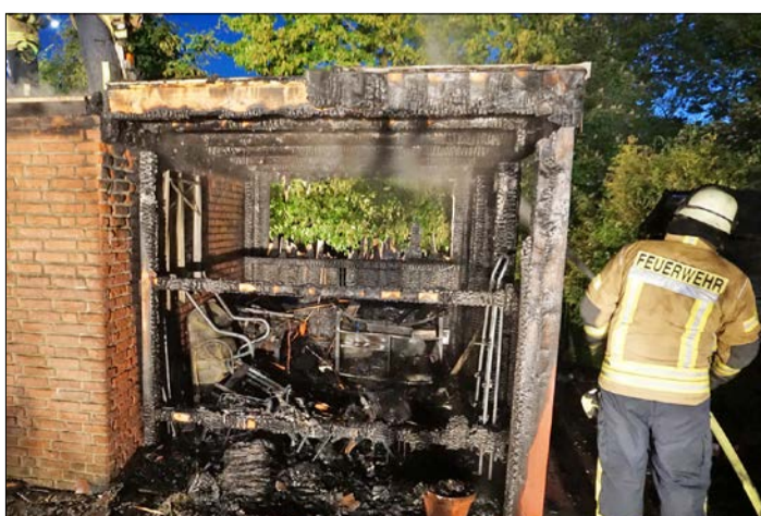
Der Garagenanbau brannte vollkommen aus.
