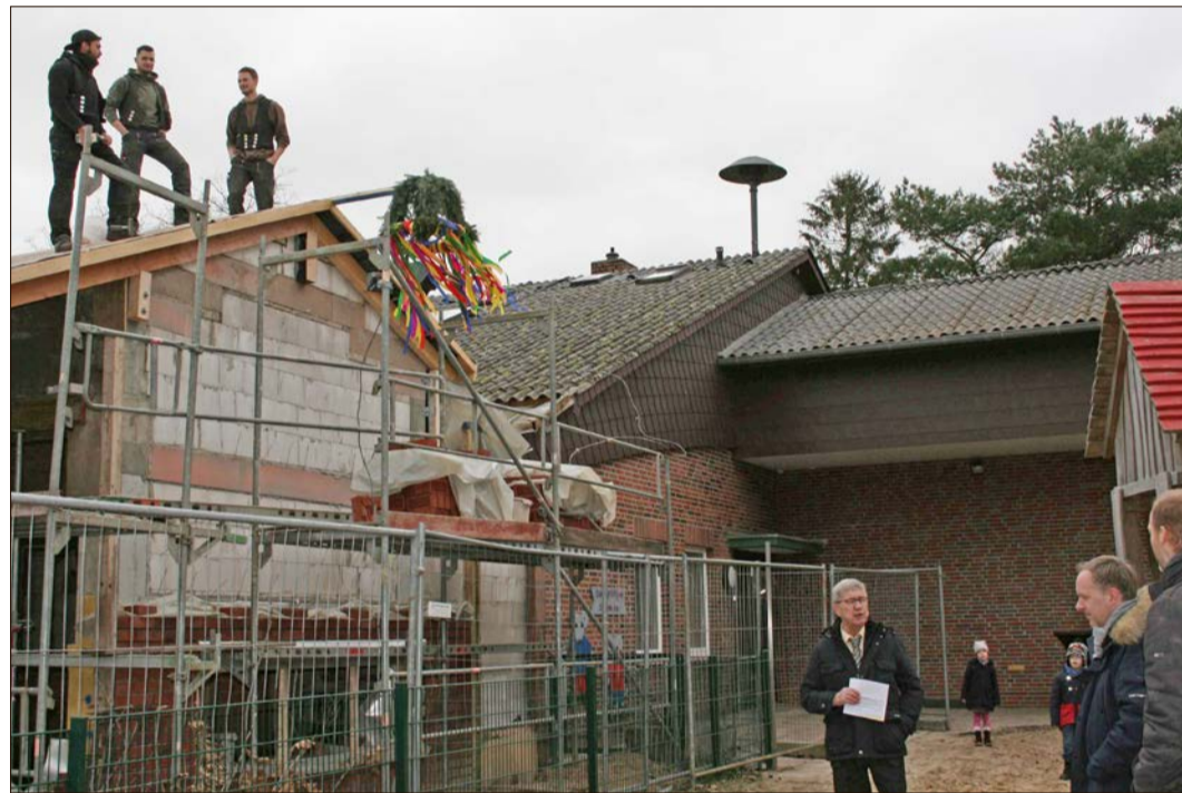
Richtfest für den Erweiterungsbau am Dorfgemeinschaftshaus in der Schneverdingen Ortschaft Wesseloh. Hans-Jürgen Thömen (unten li.) begrüßte als stellvertretender Bürgermeister die Gäste. Fotos: J. Meyer
