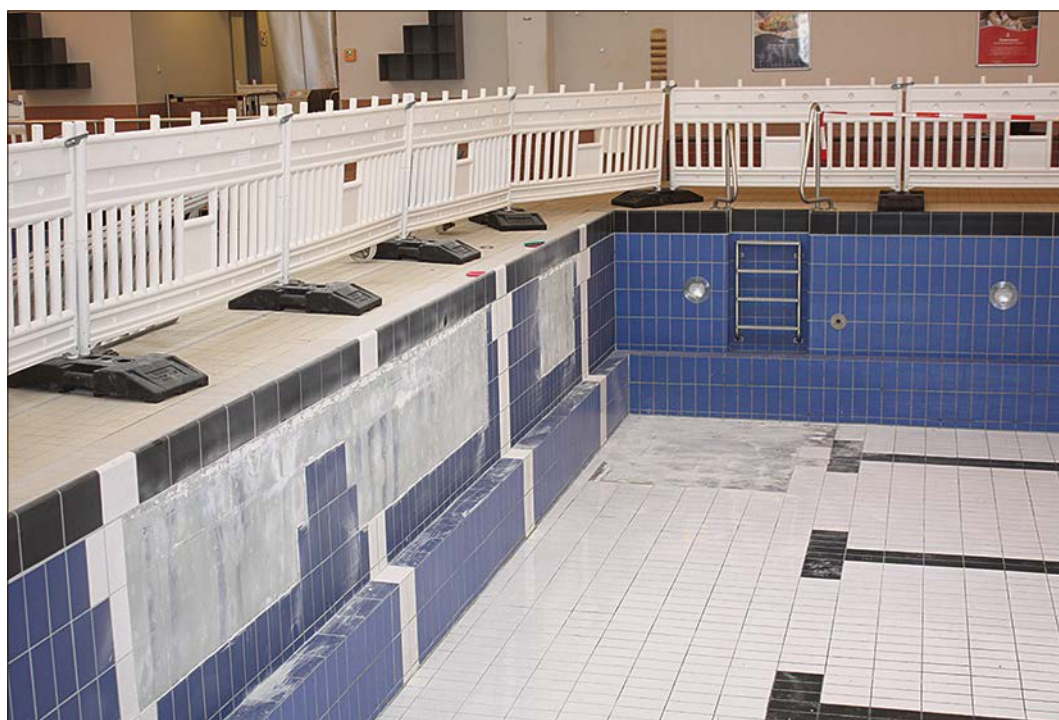
Fliesenschäden im Soltauer Hallenbad: Die Sanierungsarbeiten sollen Mitte Juli beginnen und Ende des Jahres abgeschlossen sein. Foto: mwi
