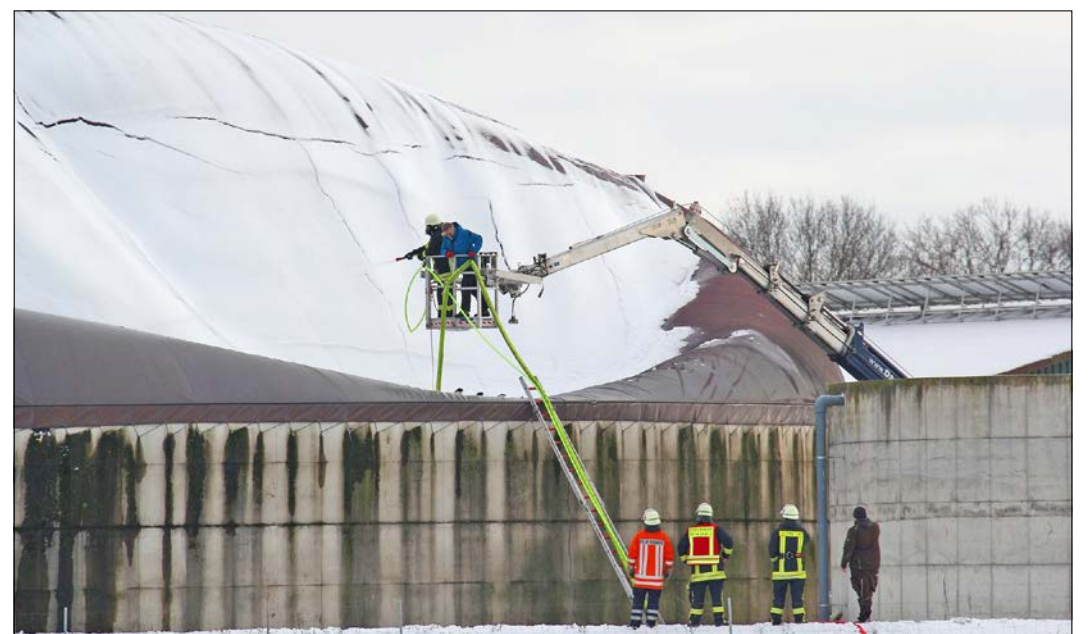
Knapp zehn Stunden dauerte der Einsatz an der Biogasanlage. Mit viel Engagement kämpften die Feuerwehrleute bei Eiseskälte darum, die eingefallenen Dächer wieder aufzurichten. Foto: Thomas Klamet
